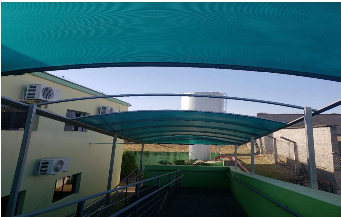
Foto 7 - Nesta imagem da parte posterior da edificação, podemos notar que não existe nenhum tipo de avarias com relação a estrutura da edificação, apenas a necessidade de pintura externa para proteção e estética. Também podemos notar algumas trincas e umidade no revestimento. Também a necessidade de reposição e troca da telha de policarbonato da cobertura do acesso ao pavimento superior.
