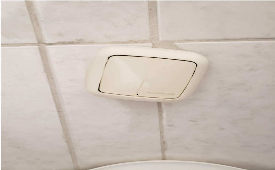
Foto 17- Nesta Imagem podemos notar que o dispositivo de acionamento da descarga está totalmente torto e aparentemente danificado.
