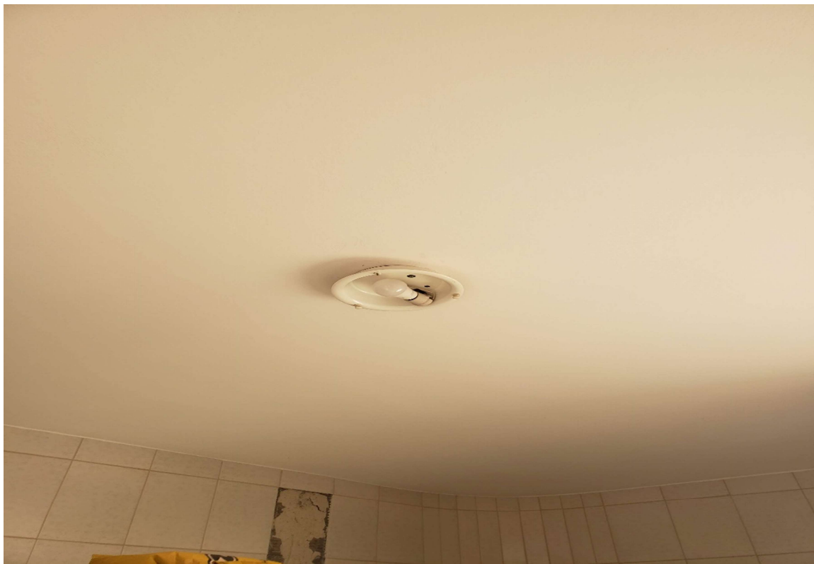
Foto 16- Nesta imagem podemos notar que alguns pontos de elétrica necessitam de ajustes e reposição de peças.
