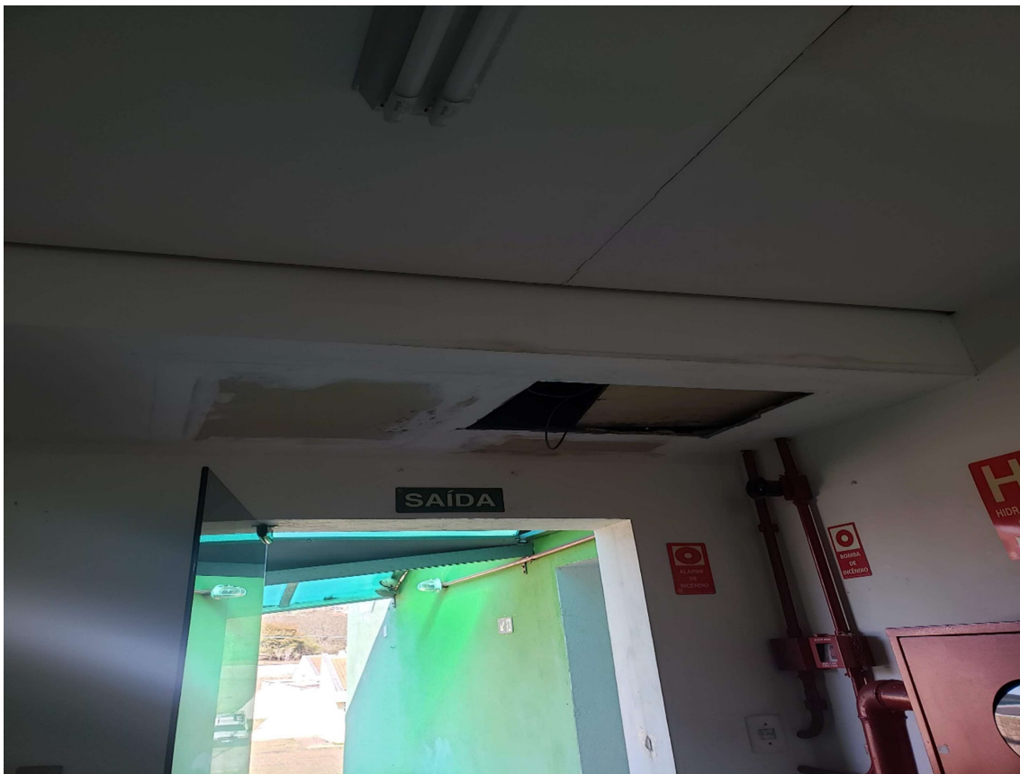
Foto 20 - Nesta imagem, podemos notar que a maior parte do forro de gesso que existe na parte superior da edificação, apresentam avarias devido a vazamentos da cobertura.
