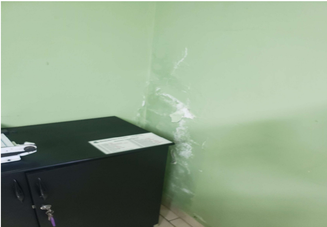
Foto 23 - Nesta imagem podemos notar a existência de infiltração de água da mesma parede citada na figura 6.
