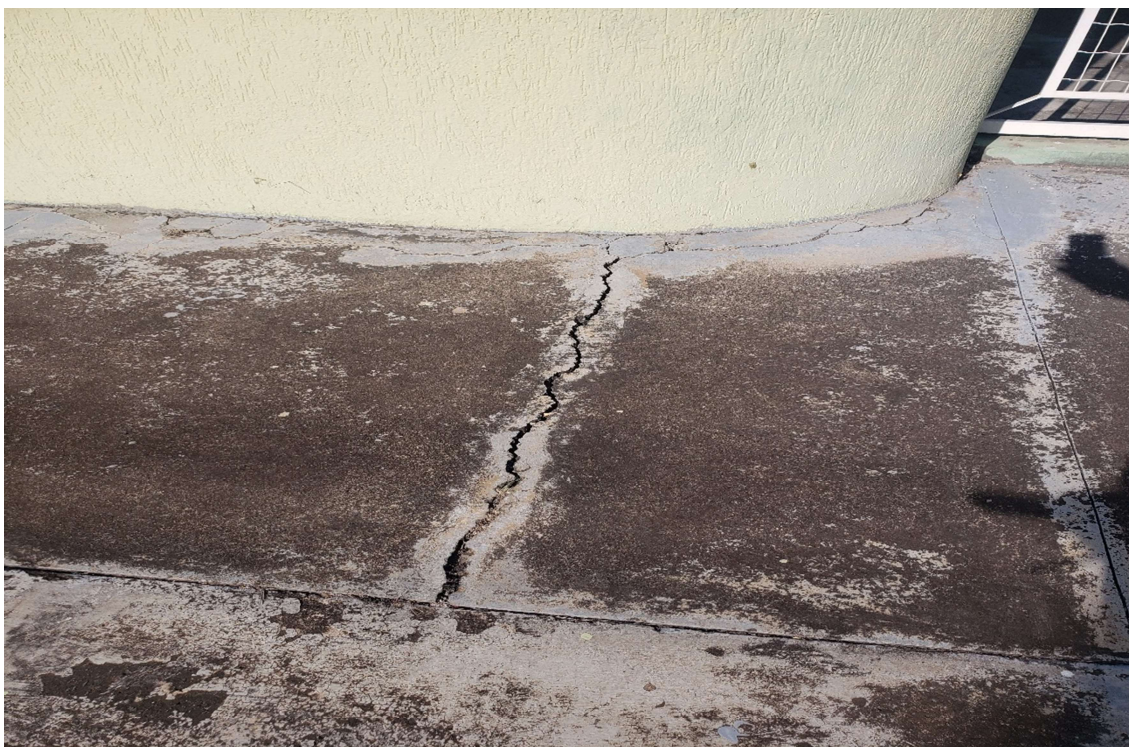
Foto 13 – Nesta imagem podemos notar trincas no piso externo, onde serão necessários e alguns pontos a substituição do concreto, o tratamento de todas as trincas existentes, regularização para destinar o fluxo de águas pluviais e pôr fim a impermeabilização através de pintura para piso.
