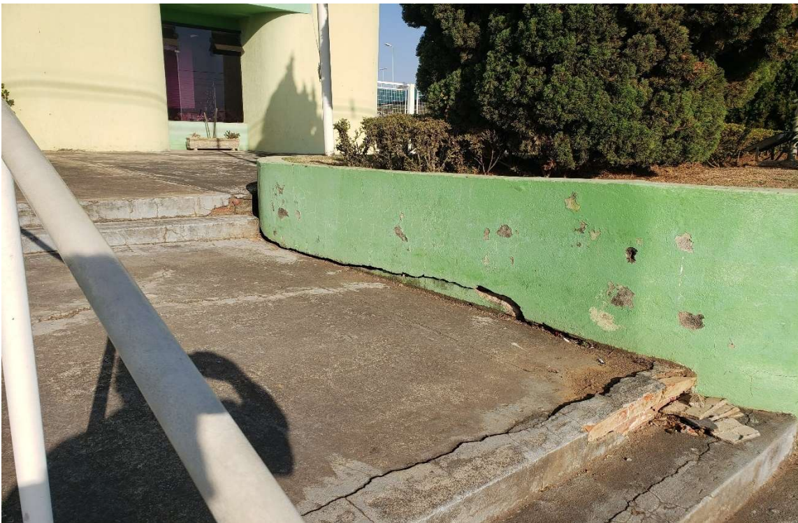
Foto 12 - Imagem do muro de contenção do jardim frontal, mesmo problema da foto 8, contudo, a estrutura apresenta trinca horizontal além de outras patologias, perigo eminente de colapso.
