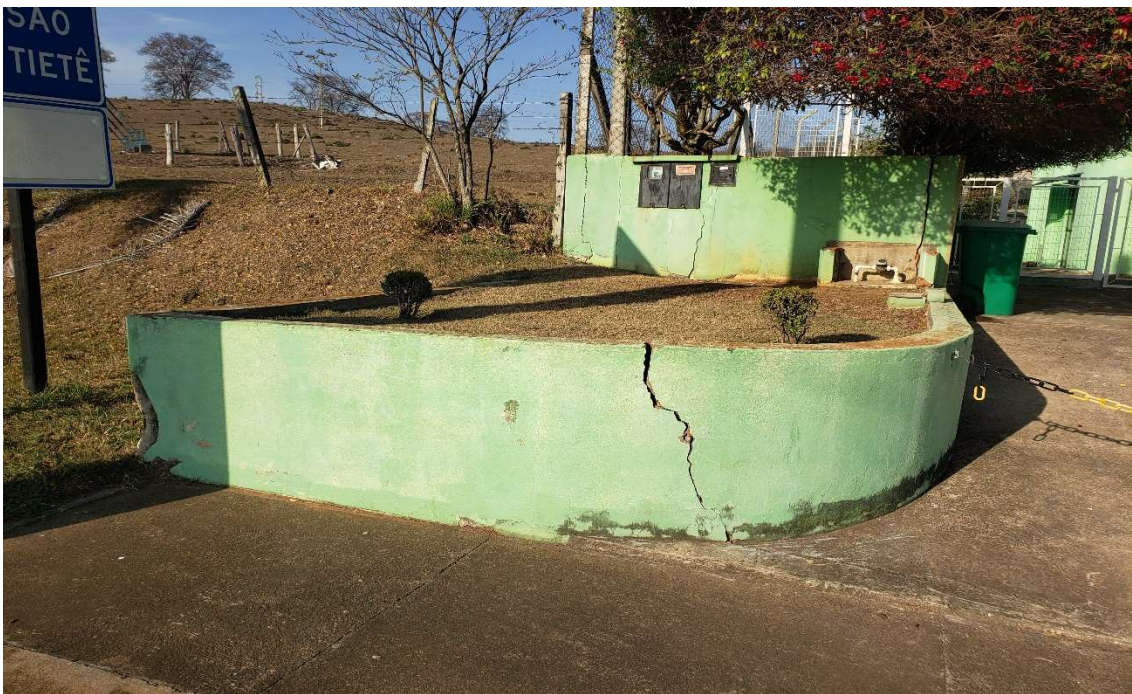
Foto 8 – Nesta imagem podemos notar que os muros de contenção dos jardins estão estruturalmente danificados, sendo necessário o reforço ou a substituição da estrutura, além de um possível sistema de drenagem para alívio da carga de empuxo na estrutura.
