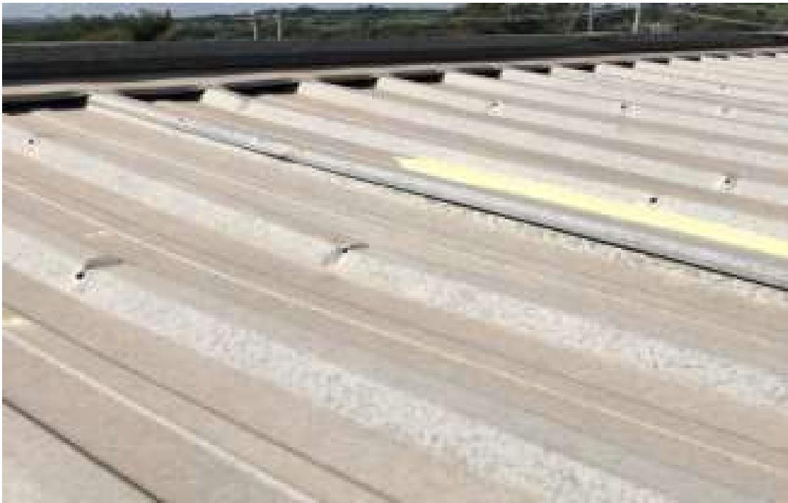
Foto 24 - Nesta imagem podemos notar vários furos na telha, como também partes amassadas e mal fixadas.
