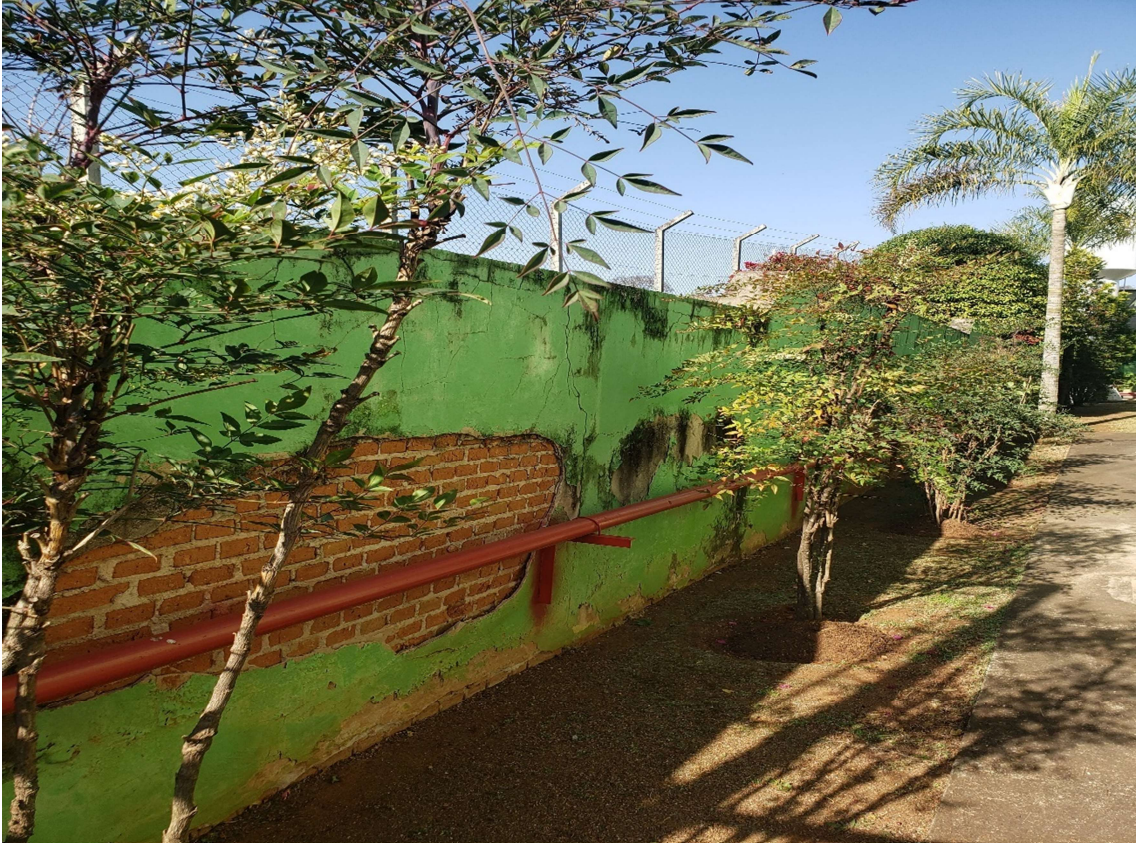
Foto 11 – Imagem do muro de contenção da lateral esquerda, mesmo problema da foto 8, contudo, a estrutura apresenta desaprumo além de outras patologias, perigo eminente de colapso.
