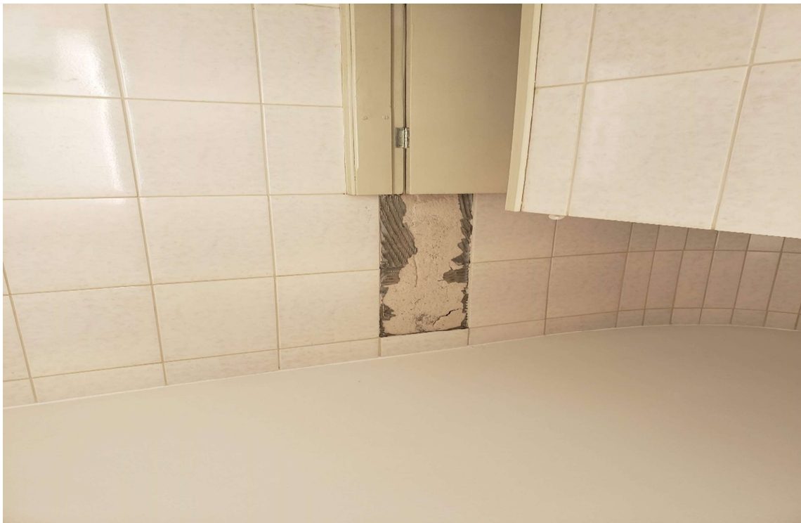
Foto 15 – Nos banheiros do térreo, serão necessários a troca e reposição de revestimentos cerâmicos, sendo que a causa do descolamento das placas cêricas aparentemente se da ao fato do mal assentamento.
