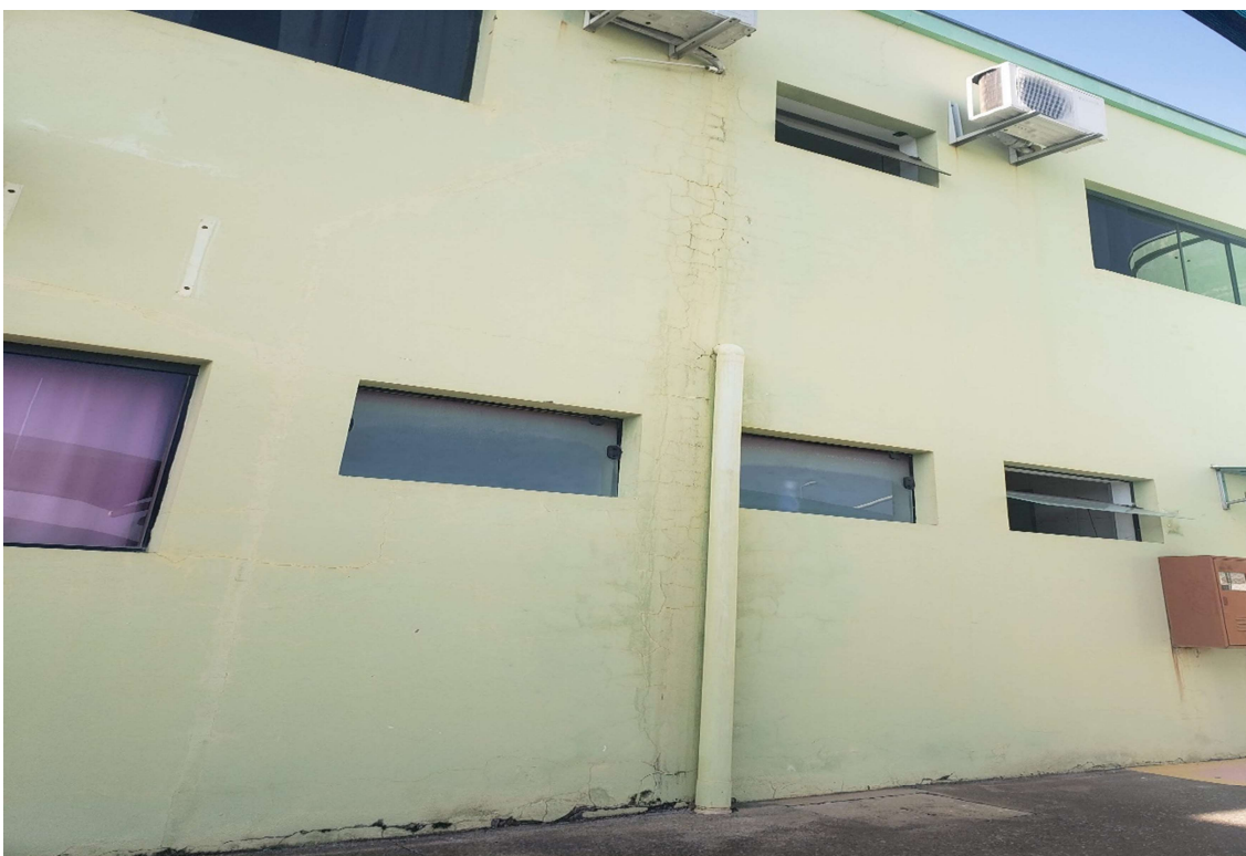
Foto 6 - Nesta imagem da lateral direita da edificação, podemos notar que não existe nenhum tipo de avarias com relação a estrutura da edificação, porém podemos notar que há uma linha vertical úmida demonstrando que existe umidade na parte interna da alvenaria, neste local será necessário a remoção do revestimento para identificação do local onde há indícios de vazamento, após estancar o vazamento, e refazer o revestimento, haverá a necessidade de pintura externa para proteção e estética. Também podemos notar algumas trincas e umidade no revestimento, que deverão receber o devido tratamento através de polímeros impermeabilizantes para trincas, malhas de pintura e pintura acrílica.
