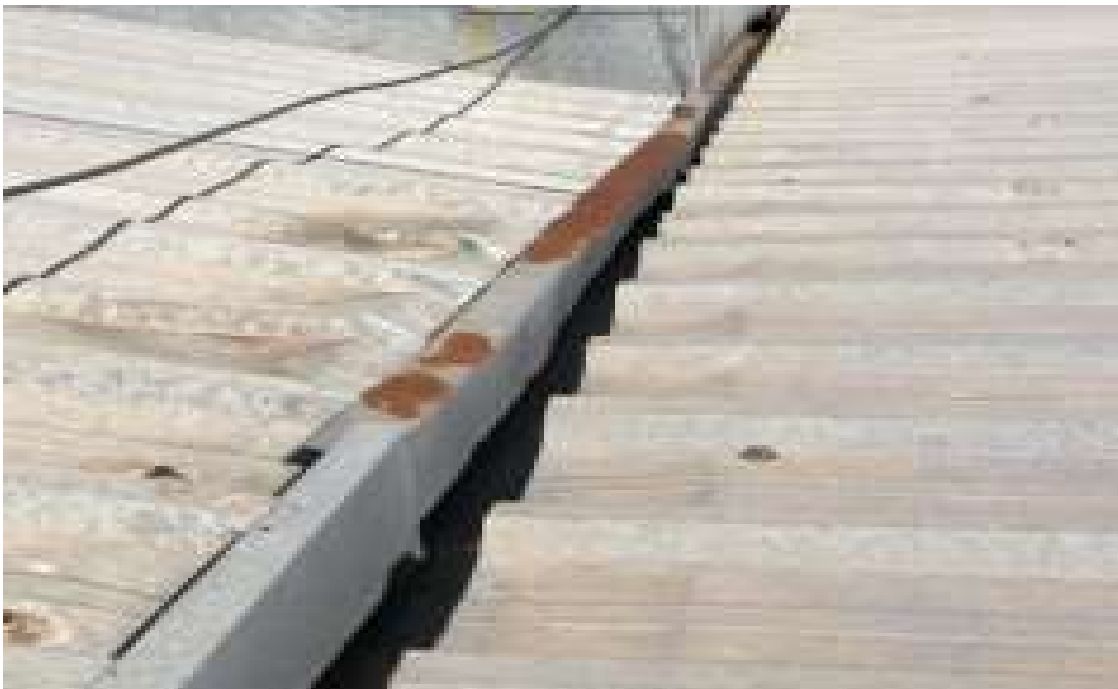
Foto 26 - Nesta imagem podemos notar que as telhas estão muito curtas, não entrando o suficiente para uma captação eficiente da calha.
