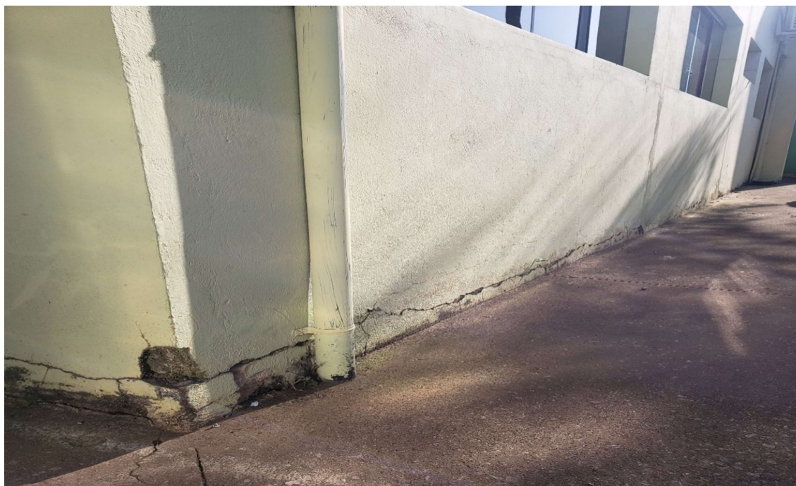
Foto 4 - Nesta imagem da lateral esquerda da edificação, podemos notar algumas trincas e umidade no revestimento, para este local será necessário a remoção de parte do revestimento, para posteriormente executar o serviço de impermeabilização na alvenaria e enfim, aplicar o revestimento argamassado novamente. Também será necessário a regularização e impermeabilização do piso externo para direcionar o fluxo das águas pluviais ao centro do piso, assim evitando futuras infiltrações.
