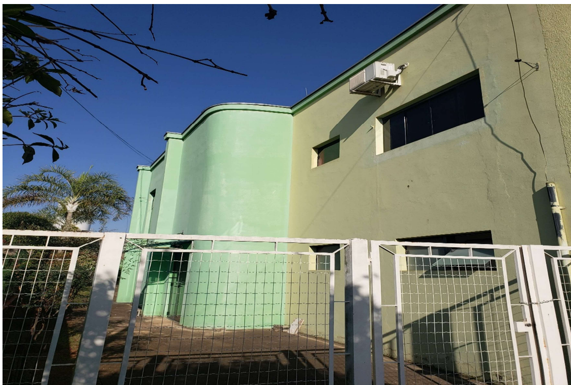
Foto 3 – Nesta imagem da lateral esquerda da edificação, podemos notar que não existe nenhum tipo de avarias com relação a estrutura da edificação, apenas a necessidade de pintura externa para proteção e estética. Também podemos notar algumas trincas e umidade no revestimento.
