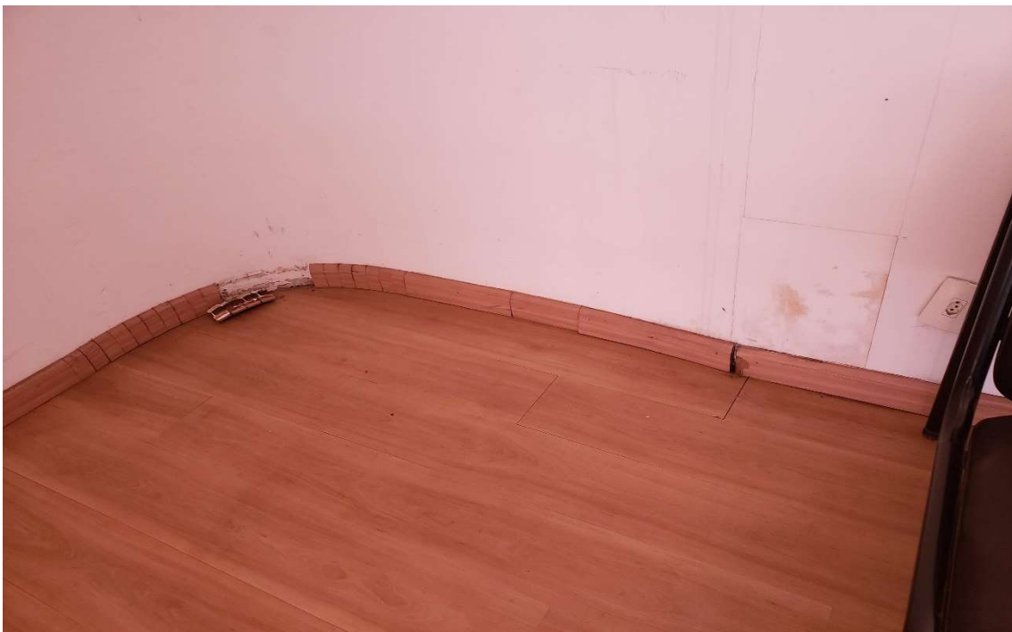
Foto 18 - Nesta Imagem podemos notar que o rodapé está totalmente danificado, como também ponto de elétrica solto e totalmente torto.
